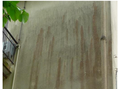
facciata interessata da muffe e alghe
