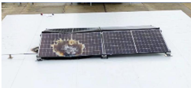
Tetto piano con EPS e rivestito con strato cementizio sovrastante – Danno che mostra la propagazione dell'incendio che risulta essere di entità trascurabile.
