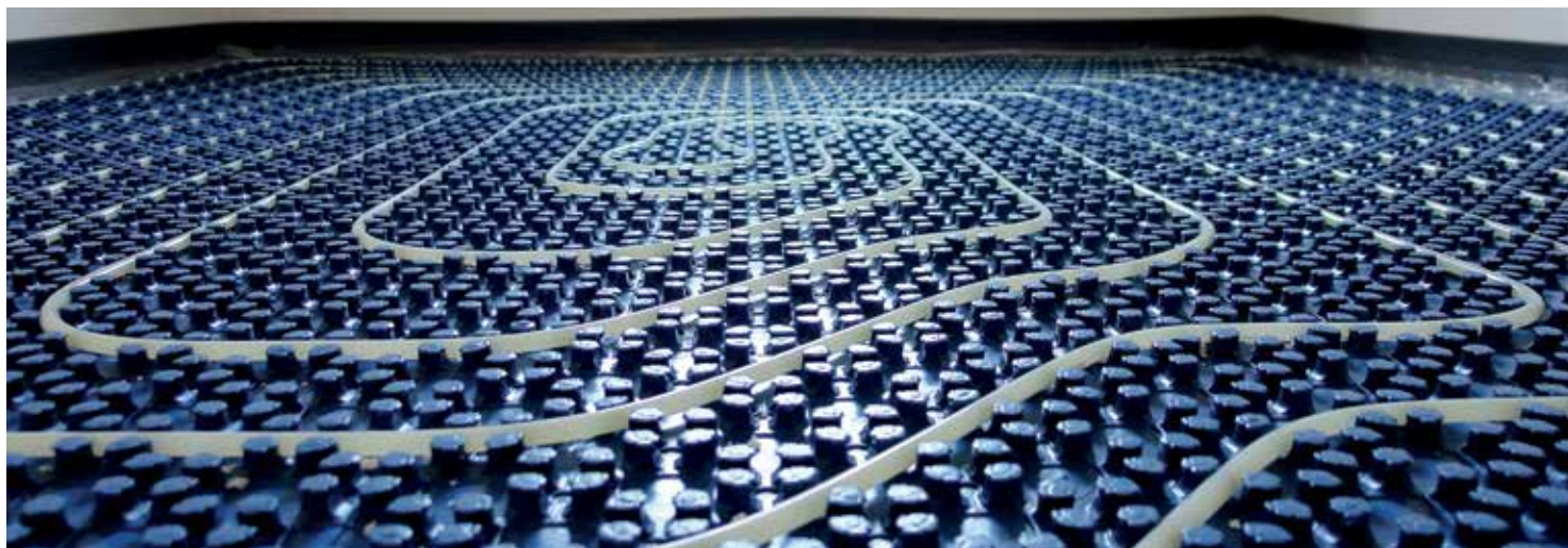
I pannelli radianti a pavimento garantiscono un riscaldamento uniforme e confortevole, riducendo consumi energetici e moti convettivi d'aria grazie a un sistema a bassa temperatura e alta componente radiativa
