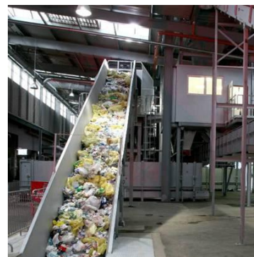
Foto: Impianto di selezione di rifiuti
