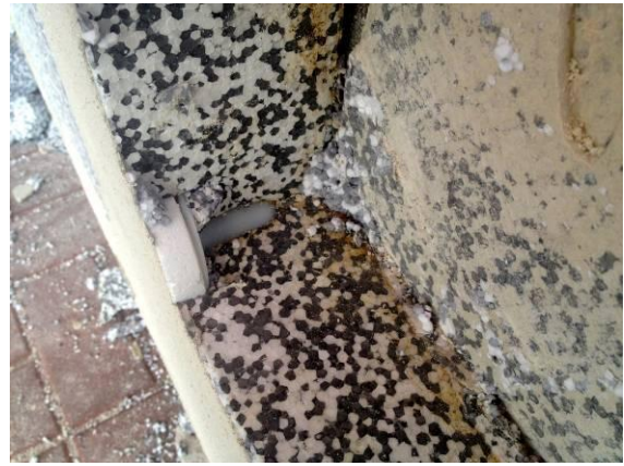
Particolare con tassello posato correttamente tra i giunti dei pannelli e rondella in EPS davanti al tassello
