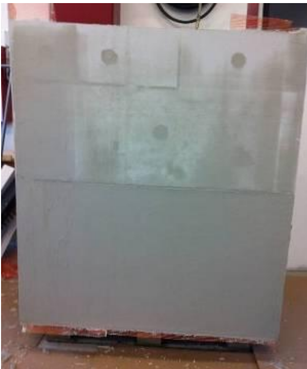
Durante l'asciugatura del rasante posato nello stesso periodo la parte bassa con una rasatura e un sistema uniforme asciuga uniformemente a differenza della parte alta
