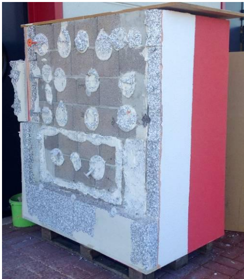
Rimosso il rivestimento e il sistema a cappotto nella parte alta è presente il sistema di incollaggio non corretto per punti, nella parte bassa il sistema di incollaggio corretto con cordolo e tre punti all'interno
