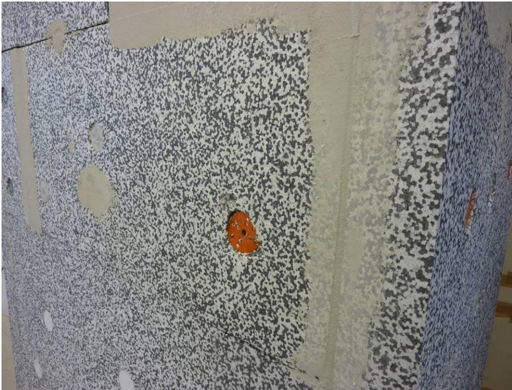
Ingrandimento parte frontale con errori di posa
