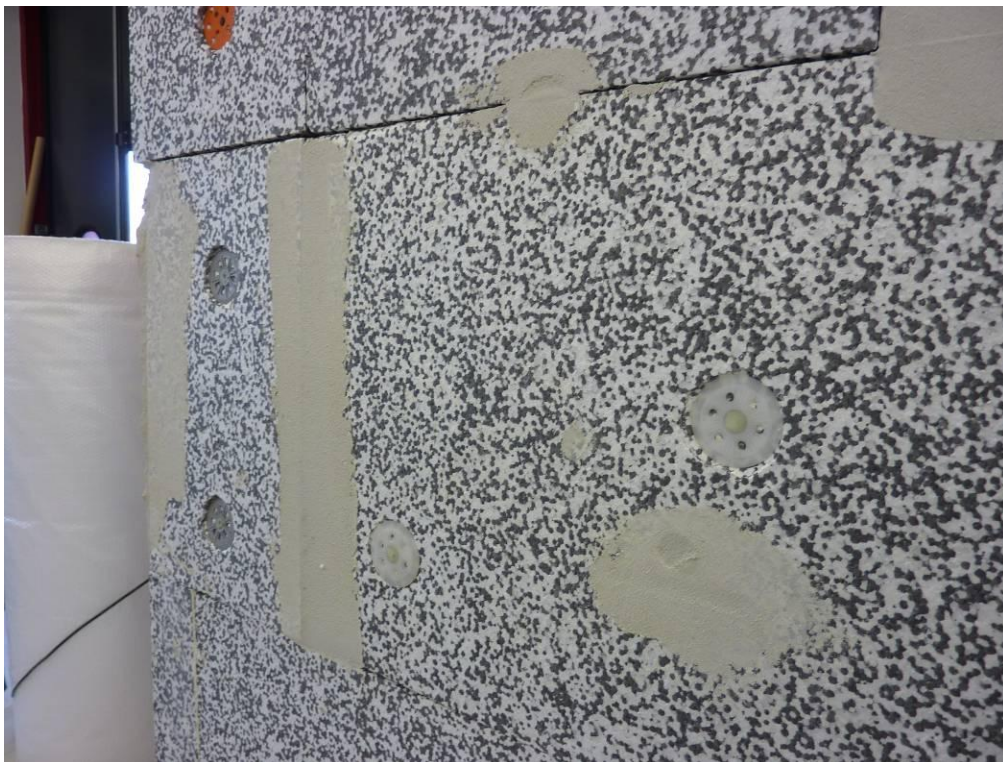
Ingrandimento parte frontale con errori di posa
