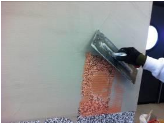
Dettaglio della parte alta con l'errore di posa nella rasatura della rete: si appoggia le rete e si rassa
