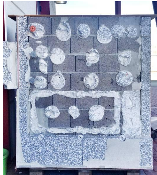
Rimosso il rivestimento e il sistema a cappotto nella parte alta è presente il sistema di incollaggio non corretto per punti, nella parte bassa il sistema di incollaggio corretto con cordolo e tre punti all'interno
