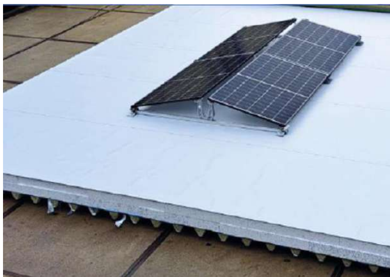
Sistema fotovoltaico testato costituito da moduli fotovoltaici orientati est-ovest
